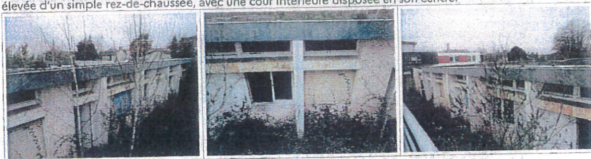
Le bâtiment inaccessible à la visite se trouve dans un état de dégradation plus avancée que le précédent. Structure béton avec toit terrasse en très mauvais état, bâtiment encerclé par la végétation en friche.
